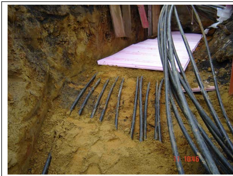
Abb. 6 Vorbildlich verlegte PE-Anschlussleitungen zum Verteiler. Hier werden Vor- und Rückläufe sogar thermisch durch eine Isoliermatte getrennt.
